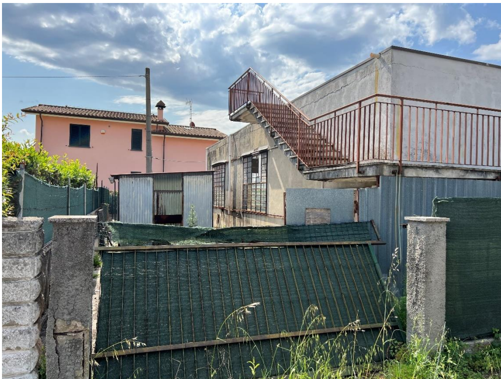
Linea elettrica interna al lotto
